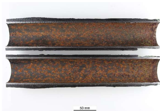
Aufgetrenntes Sprinklerrohr mit Korrosion auf der Innenseite
