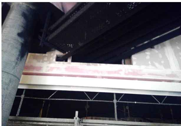
Objektspezifische Einzellösung als Unterkonstruktion einer Rauchschürze in einem Bestandsgebäude
